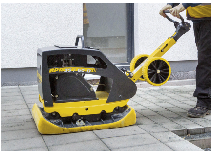
Geen gebroken bestrating
